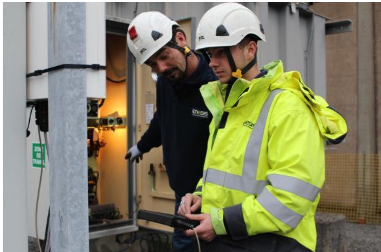
Photographie 76. Mise en service par ENEDIS
